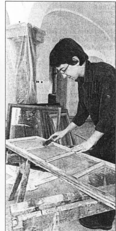
Silvia hilft beim Aufarbeiten von Fenstern im Säulenraum des vorderen Torhauses im Schloss.
